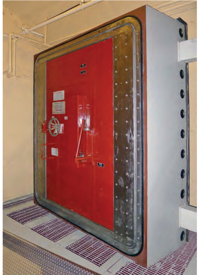
LCEB blast door
